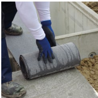
Auf der Betondecke wird zunächst eine Bitumenpappe R500 ausgelegt (Stöße 20 cm überlappend).
