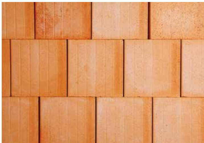
Normgerechtes Überbindemaß und trockene Wand 01
