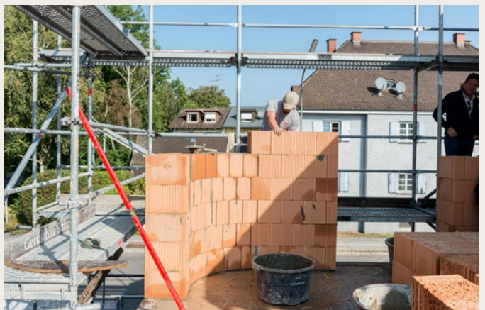
Reihe für Reihe wächst der Rohbau. Mit Hilfe von Lot, Wasserwaage und Rundschaablonen lassen sich die Ziegel kontrollieren und ausrichten.
