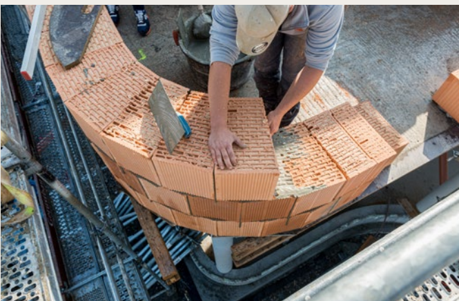
Das Versetzen der Ziegel beginnt immer von einer Seite aus. In der Rundung sind die Ziegelreihen gegeneinander um eine halbe Ziegelbreite versetzt.
