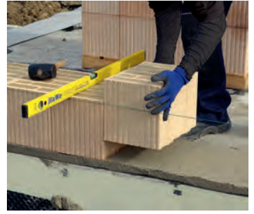
Sobald der Mörtel etwas angesteift ist, wird die erste Planziegelschicht lot- und fluchtgerecht versetzt. Sie ist die Grundlage für das exakte Hochziehen der Wand.
