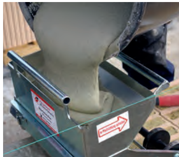
Der angerührte Dünnbettmörtel wird in die Mörtelrolle gefüllt. Zuvor sollte das Gerät mit einem Trennmittel eingesprüht werden, das erleichtert die spätere Reinigung.
