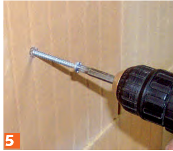
5 Angaben des Dübelherstellers zu Schraubendicke und -länge beachten, damit optimaler Halt gewährleistet ist!
