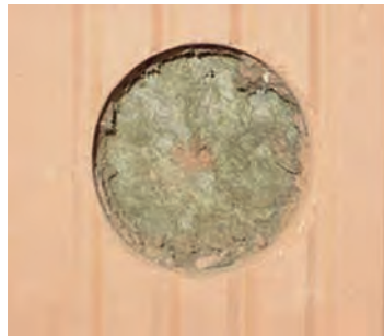
Evtl. Ziegelreste und Bohrmehl entfernen – fertig ist ein perfektes Loch für eine Elektrodose!
