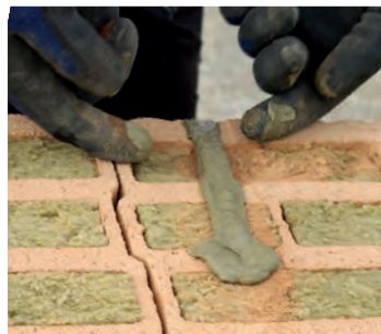
Um Verletzungen vorzubeugen wird der Maueranker vorgebogen, in Dünnbettmörtel getaucht und in die Vertiefung eingelegt.
