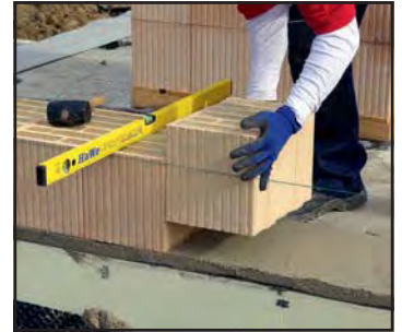
Sobald der Mörtel etwas angesteift ist, wird die erste Planziegelschicht lot- und fluchtgerecht versetzt. Sie ist die Grundlage für das exakte Hochziehen der Wand.
